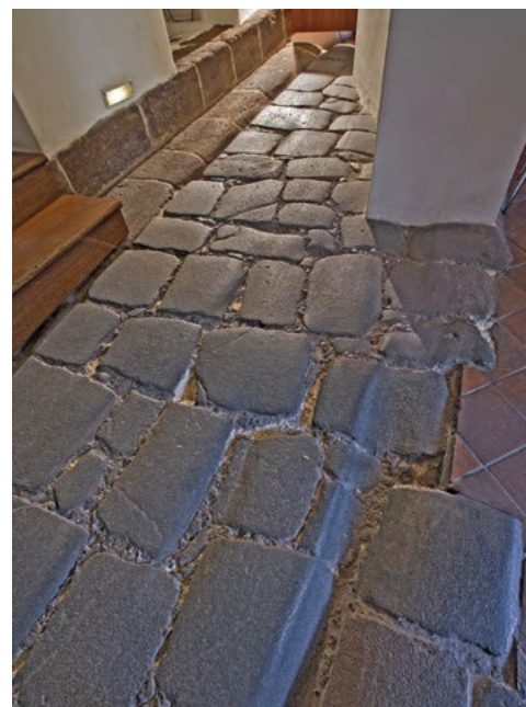
Druhá a nová vrstva povrchu Juditina mostu v přízemí domu č. p. 77 z tvrdých diabasových kamenů. Foto M. Frouz, 2007 © Národní památkový ústav, územní odborné pracoviště v Praze
