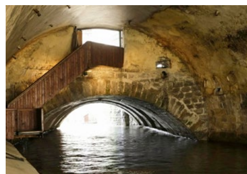
Kompletně dochovaný první mostní oblouk Juditina mostu na staroměstské straně v pohledu od přístaviště výletních lodí pod obloukem Karlova mostu. Foto V. Kašpar, 2019
