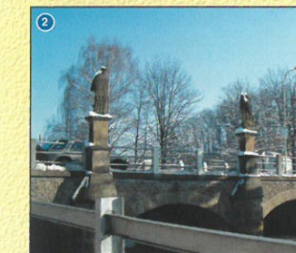
Kamenný most přes Tichou Orlici - technická památka z roku 1840 s přenesenými sochami sv. Jana Nepomuckého a sv. Floriana.
