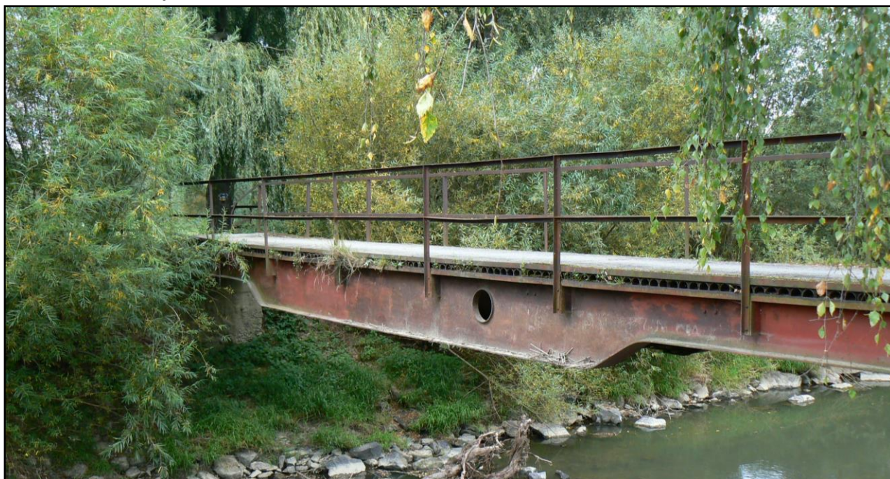
Oderská lávka před opravou
